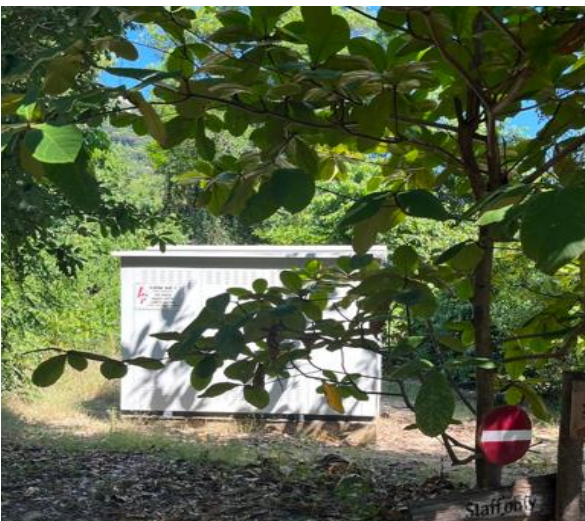
Trạm biến áp
