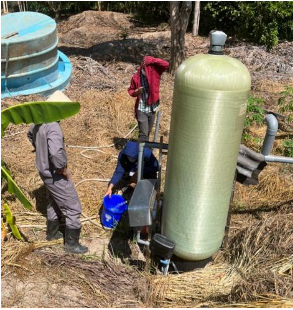
Nước thải đầu ra sau HT lọc khử trùng trạm C
