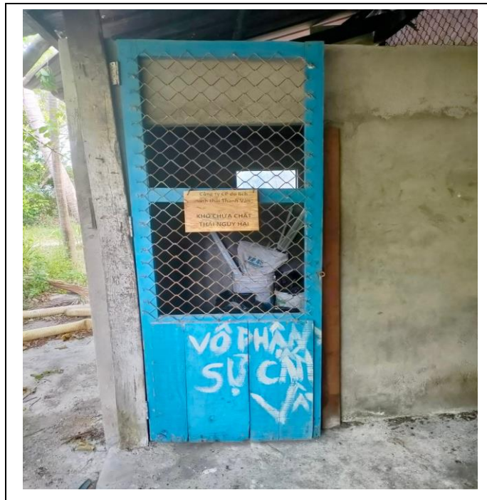
Hình 3. 3. Kho chứa chất thải nguy hại tại Khu du lịch sinh thái Thanh vân
