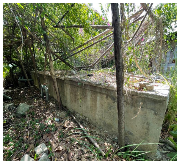
Bể điều hòa trạm A
