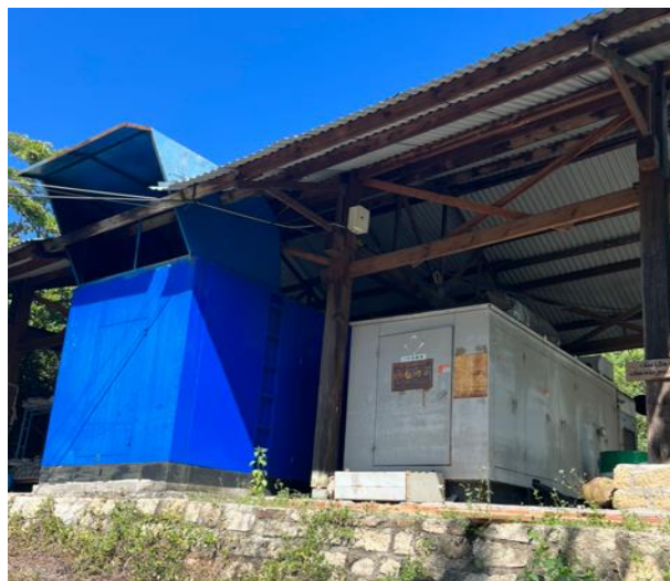
Máy phát điện
